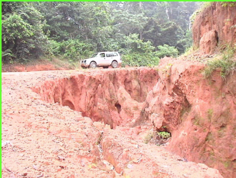
Erosion: mauvaise construction des routes
